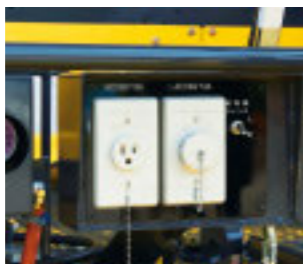
コンセント部
